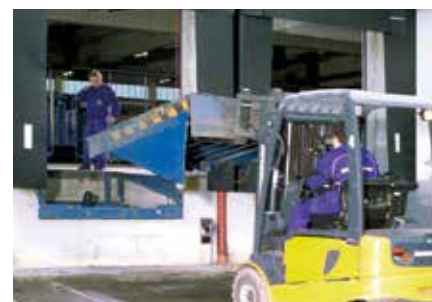
Demontaż starej ramy przeładunkowej, ewentualne dopasowanie gniazda (np. z zastosowaniem płyty montażowej lub konsoli)
